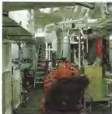
engine room • la salle des moteurs • der Maschinenraum • la sala de máquinas • la sala macchine
